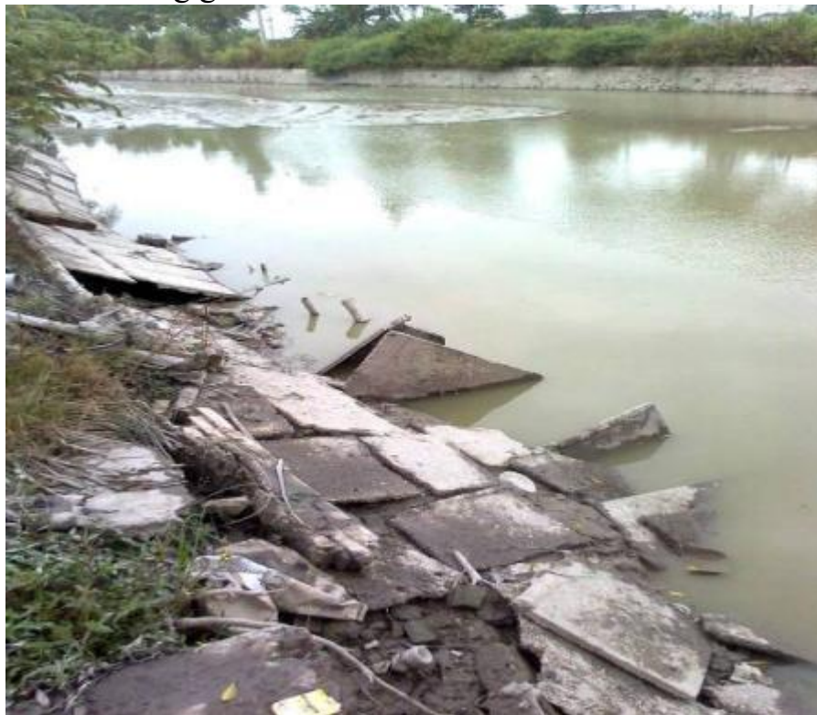
Hình 1.10: Bờ ao bị sạt lở
